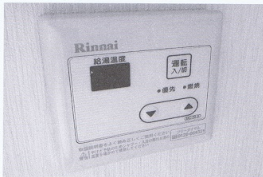
火傷防止のために施された設備
